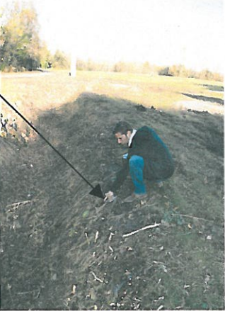
Non continuité de la géomembrane dans le fossé Ouest
